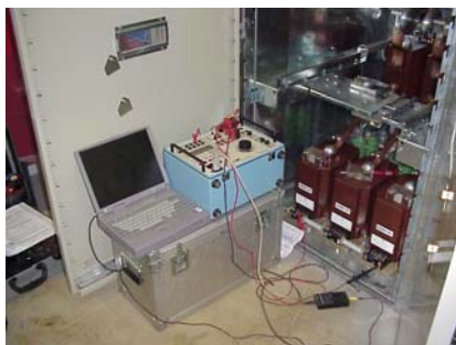
Bild: Prüfplatz an der 20-kV-Einspeisung
